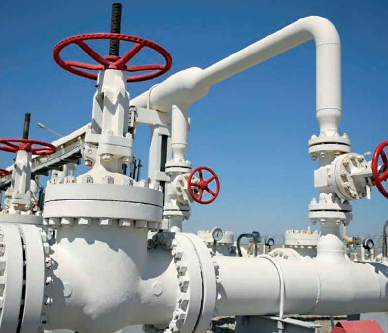
▲ Cañerías de gas natural.
